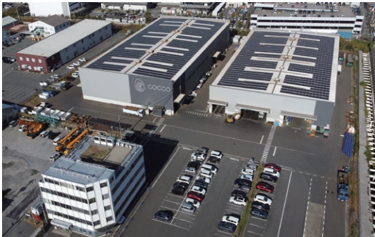
本社・呉リサイクルセンター屋上の太陽光発電設備
